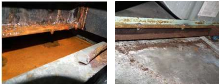
圖 18 空調系統冷卻盤管髒污情形
