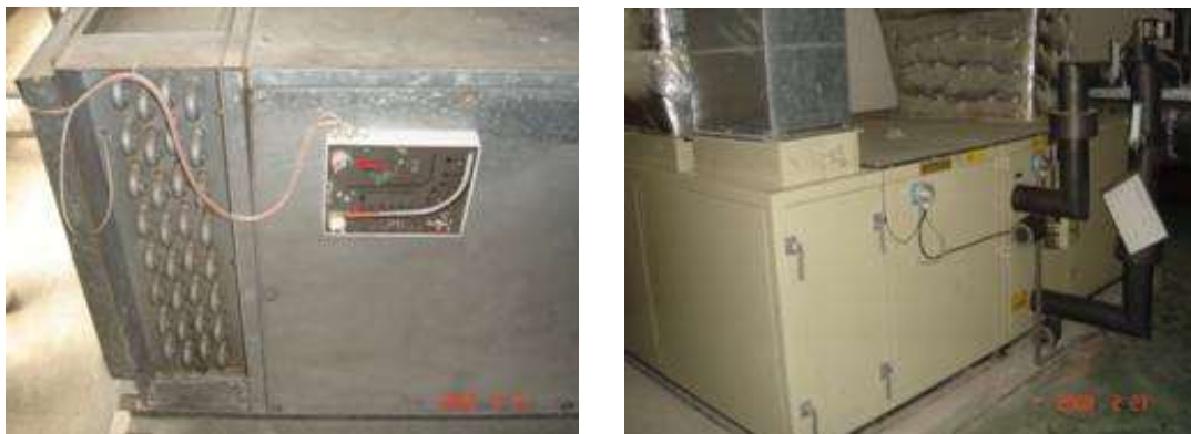
圖 38 過濾網壓差感知裝置的檢修與維護
