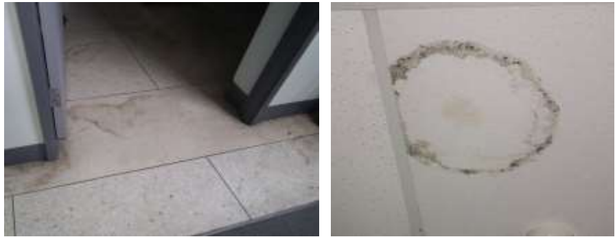
圖 12 室內環境積水或滲水所殘留水漬情形
