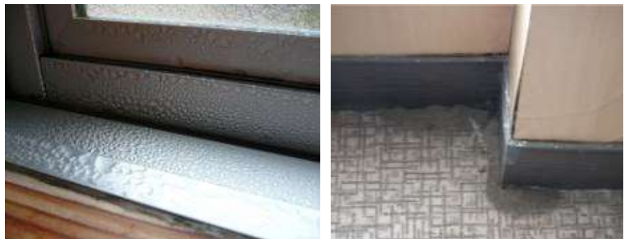
圖 13 窗台冷凝問題及木質裝潢蛀蝕情形
