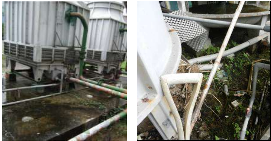
圖 27 冷卻水塔周圍環境維護不佳情形
