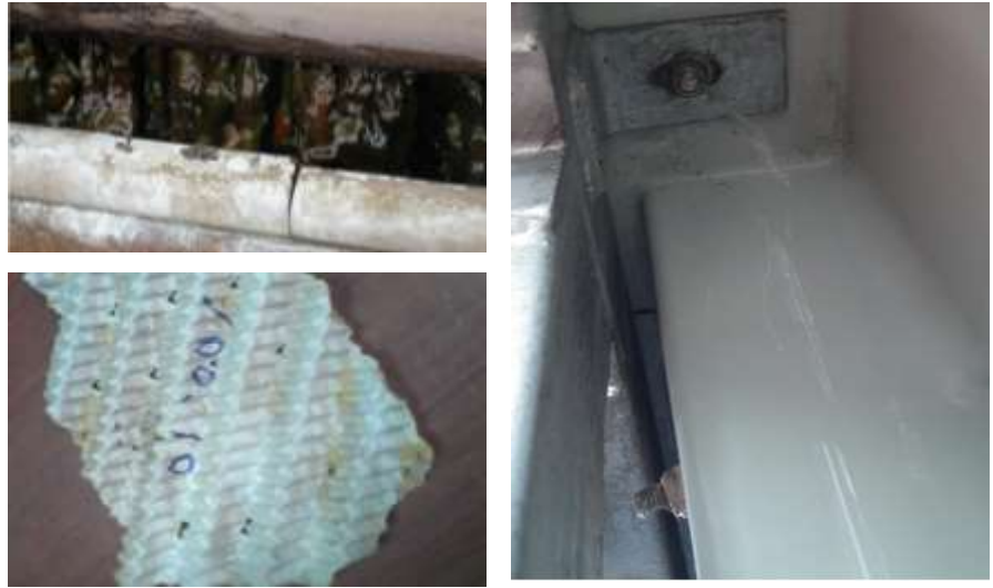
圖 26 冷卻水塔附著髒污及漏水情形
