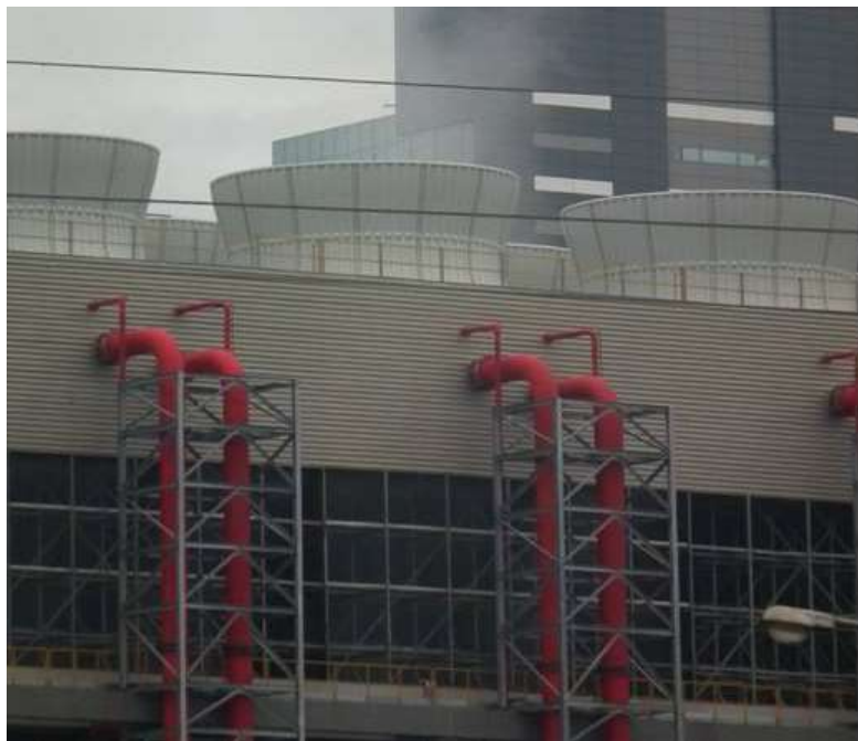
圖 25 冷卻水塔產生水霧情形
