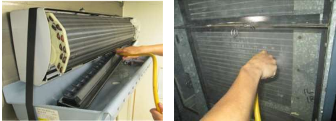
圖 35 空調室內側熱交換器清潔與維護
