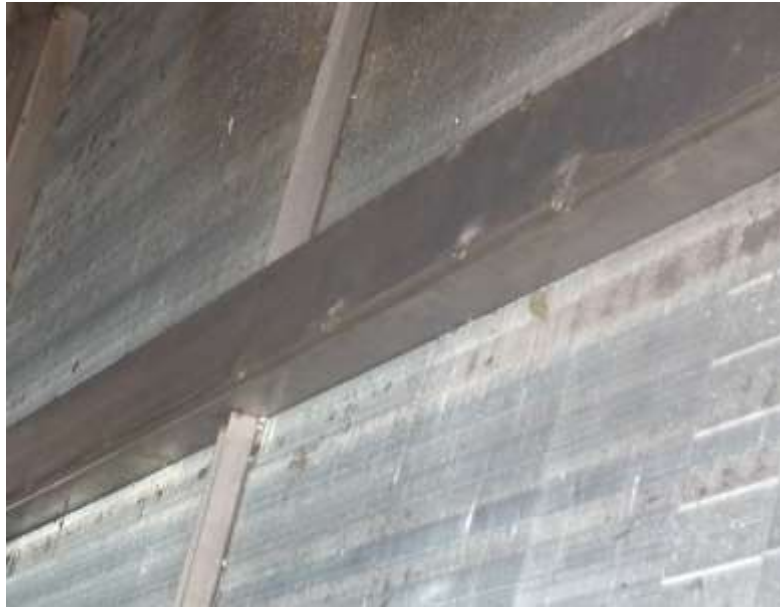
圖 17 空調系統冷卻盤管髒污情形
