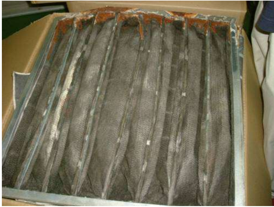
圖 19 空調系統過濾網損壞情形
