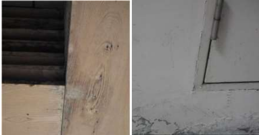
圖 14 室內建材孳生黴菌及牆面壁癌
