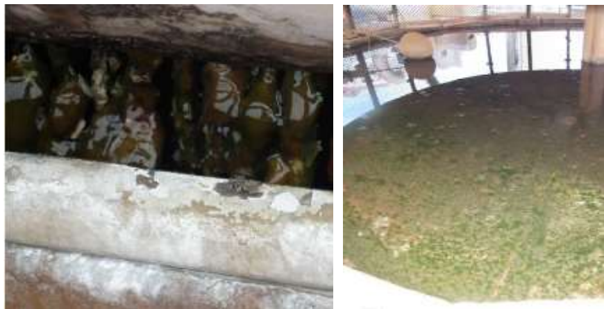
圖 24 冷卻水塔之貯水池內藻類孳生情形
