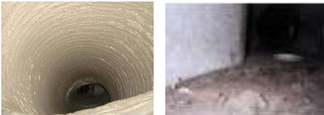
圖 41 空調風管積塵之情形
